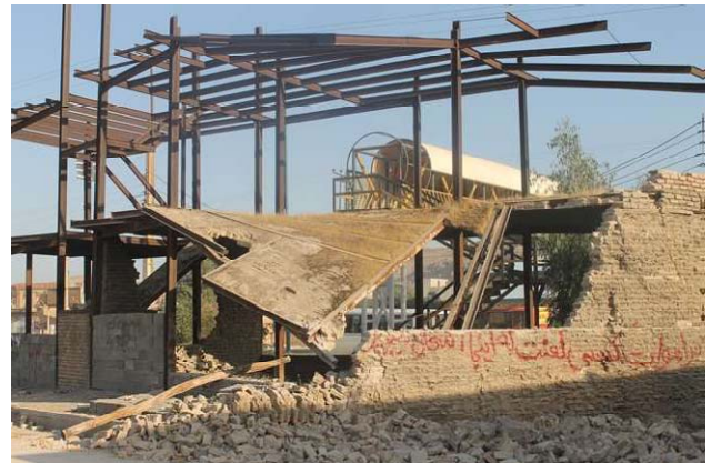
شکل ۳ - فروریزش سازه سقف فولادی و دیوار
