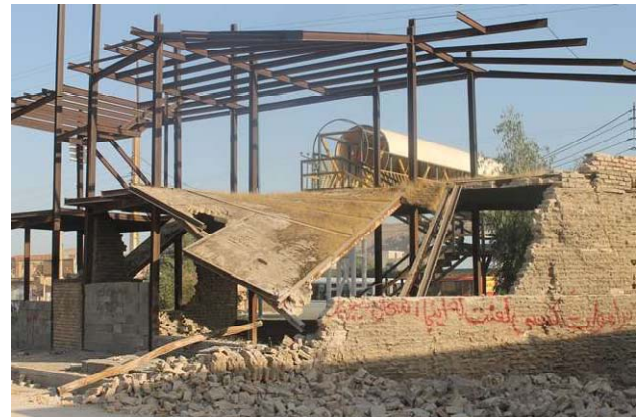
شکل ۳ - فروریزش سازه سقف فولادی و دیوار
