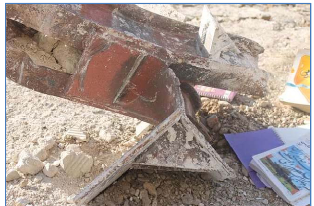
شکل ۷ - بریده شدن بست اتصال ستون
