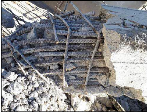
شکل ۸ - عدم رعایت ضوابط وصله های پوششی
