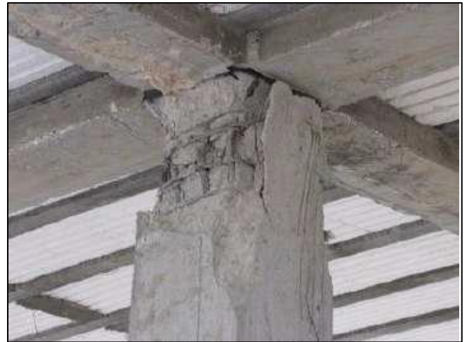
شکل ۳ - شکست برشی در ستون
