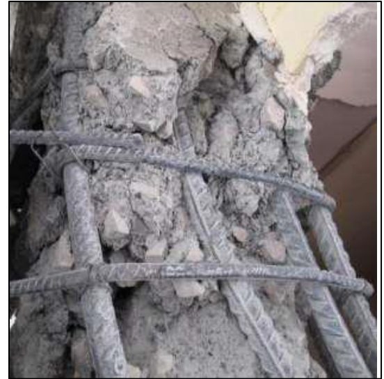
شکل ۶ - کیفیت نامناسب ریختن و نگهداری بتن
