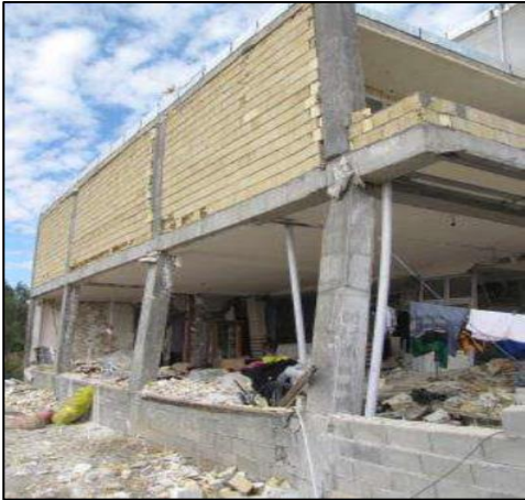
شکل ۱ - ستونهای ضعیف و ایجاد طبقه نرم
